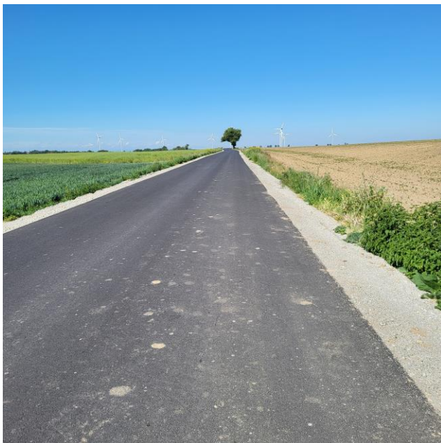
Zdjęcie: przebudowa drogi gminnej od miejscowości Piotrowice do wiaduktu na autostradzie A4
